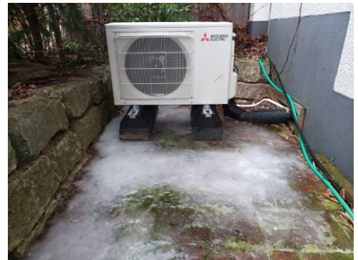
Abbildung 7: Wird das Kondensat nicht per Kondensatleitung abgeführt, kann sich bei Dauerfrost eine größere Eisfläche bilden.
