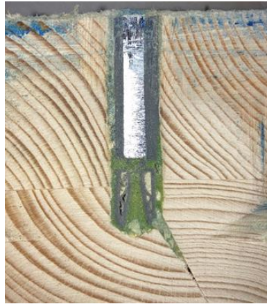
Abbildung 36: Freigesägter Querschnitt der Angewendeten Methode 4 (Injektionsdübel) in Prüfkörper 4 (7/70 mm abknickender Riss)
