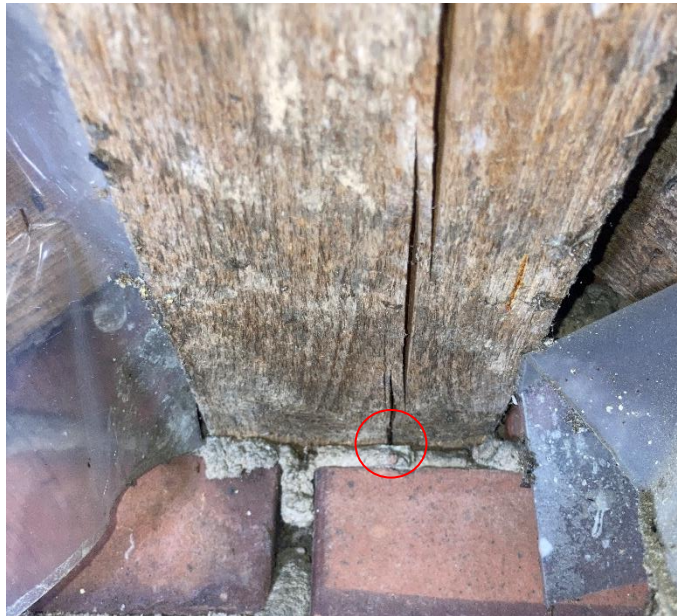
Abbildung 1: Beispielhafter Sanierungsfall eines rissigen historischen Holzbalkens, welcher die herzustellende luftdichte Ebene durchdringt
