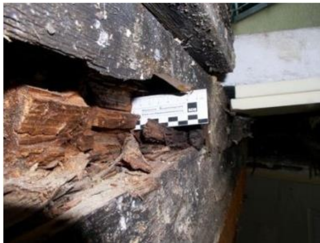
Abbildung 3: Pilzbefall durch eindringende Feuchtigkeit, der zur völligen Zerstörung bzw. zum Verlust der Tragfähigkeit der Deckenbalken geführt hat 20
