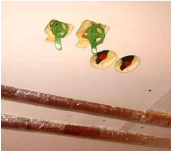
Abbildung 11: Halb und ganz in die Kellerdeckendämmung integrierte, gedämmte Rohrleitungen (Foto: Passivhaus Institut)
