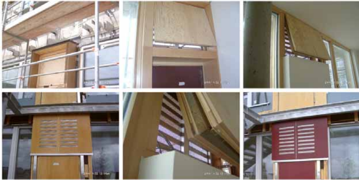
Abbildung 92: Motorisch angetriebene wärmegeädämmte Lüftungsklappen zur freien Kühlung mit Einbruchsschutz
