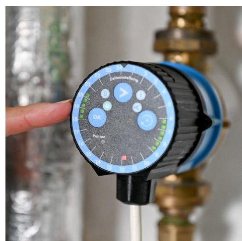
Abbildung 2: Moderne Zirkulationspumpe. Die grünen Lämpchen zeigen die Betriebszeit an.
