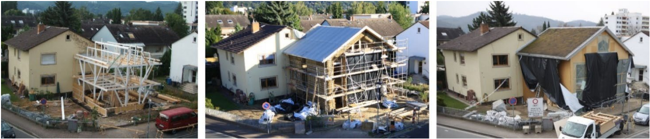
Abbildung 2: Im Bau: Tragkonstruktion steht (links), Strohballen sind verbaut (Mitte), verkleidet mit Weichfaserplatten (rechts) © Krick.
