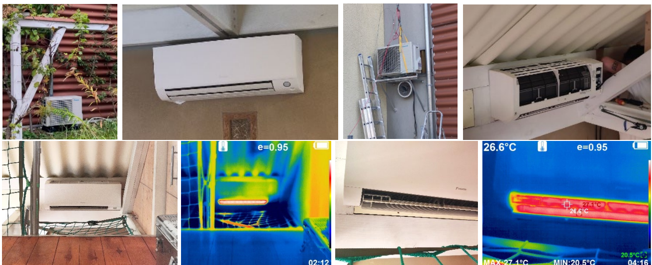
Abbildung 6: Oben: Außen- und Innengerät der EG-Wohnung (links), Außen- und Innengerät der OG-Wohnung (rechts). Unten: Echt- und Thermografie-Bild des OG-Innengerätes. © Krick.
