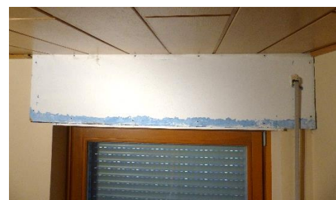
Abbildung 1: Ausgangssituation – Die Schrauben wurden bereits freigelegt, dabei ist am unteren Teil des Deckels der Putz abgefallen.
