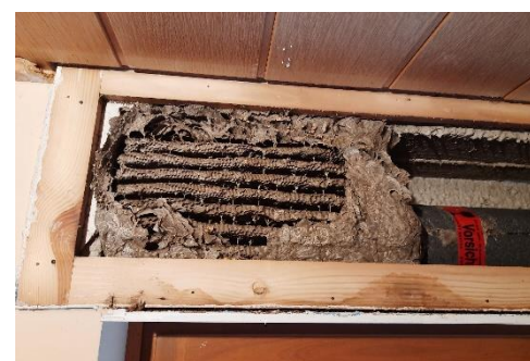
Abbildung 2: Das Wespennest im Kasten, im Hintergrund das Gehäuse des neuen Rollladens.
